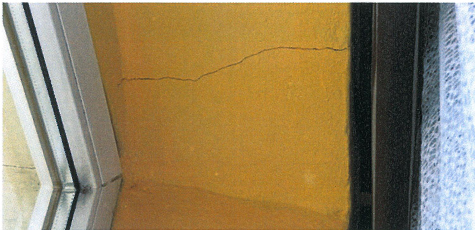
Fot. 17 Pęknięcie nadproże nad oknem pierwszego piętra (lokal nr 4).
