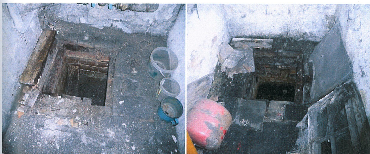
Fot. 48, 49 Studzienki zbiorcze w piwnicach o wymiarach 43x43x60 cm. Studzienka zbiorcza przy ścianie południowej jest sucha a w studzience przy ścianie północnej znajduje się woda (34 cm poniżej powierzchni posadzki).
