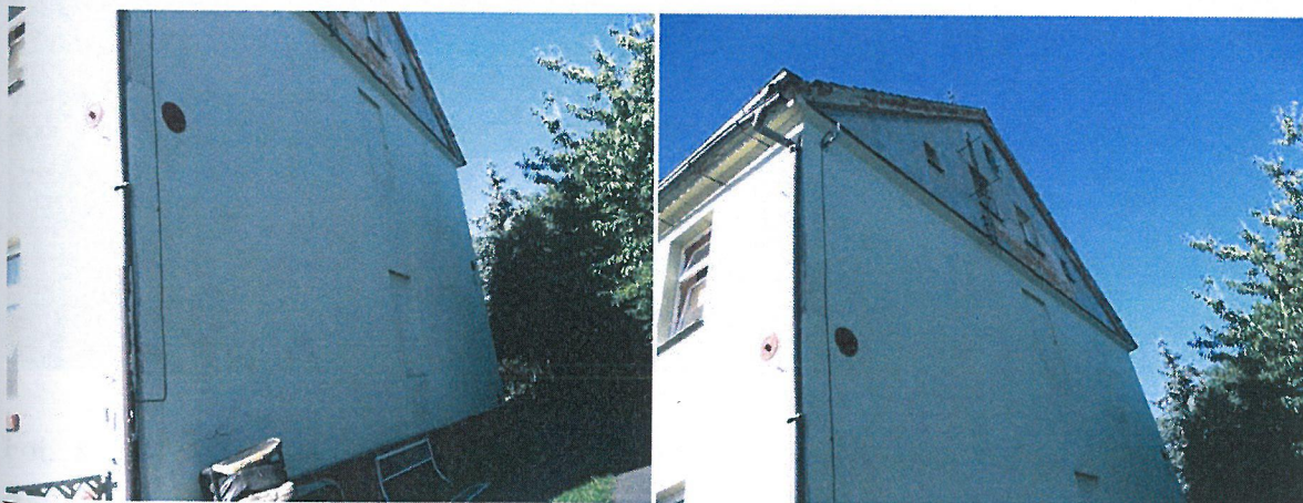
Fot. 4,5 Na ścianie północnej oraz wschodniej widać blachy oporowe ściągow wzmacniających część północną budynku. Na ścianach tych nie ma nowych pęknięć.
