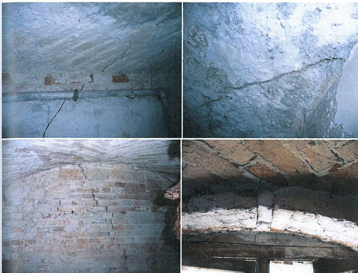
Fot. 38, 39, 40, 41 Pęknięcia ścian i sklepień w piwnicach.
