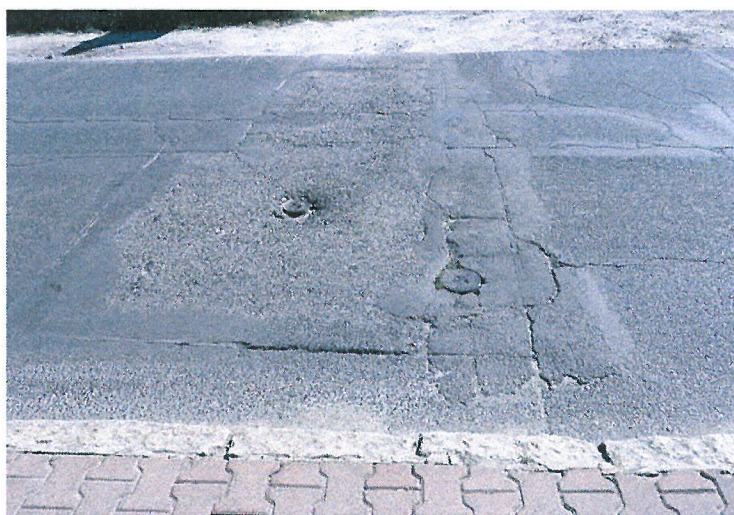
Fot. 14 Nierówna nawierzchnia drogi przy budynku przyczynia się do powstawania dużych wstrząsów i pękania ścian.
